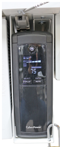
Abb. 202: Unterbrechungsfreie Stromversorgung (USV) (1)
